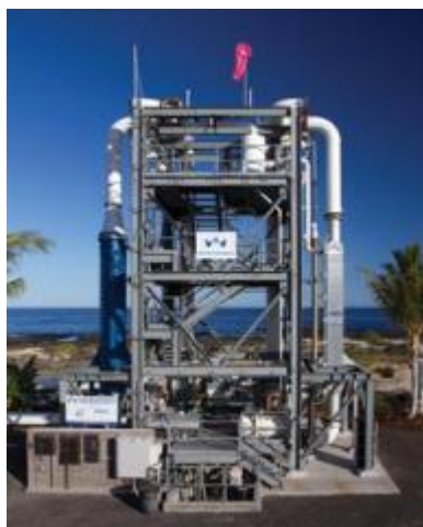
Instalación de prueba del intercambiador de calor diseñado para i+d y escalado (2011) 58
