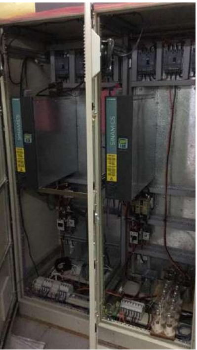
Gabinetes de potencia, módulos de PVF MPPT y baterías.
