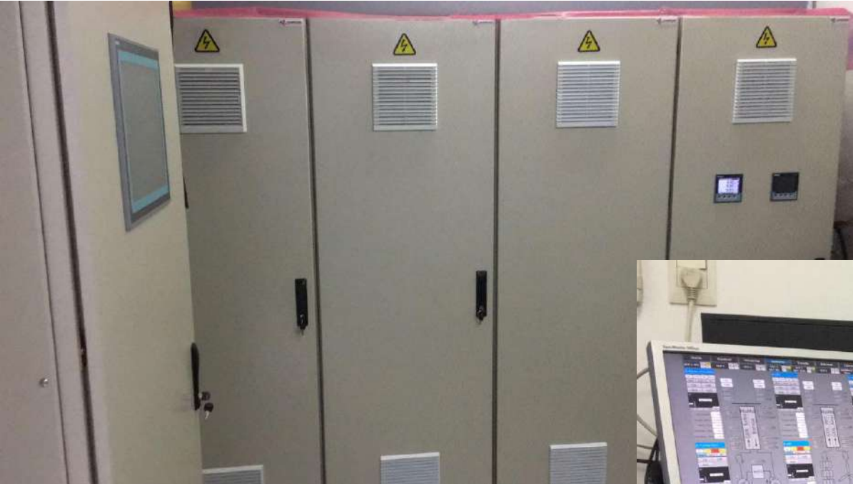
Imagen externa de los gabinetes de control y potencia del SIDEER.
