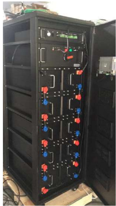
Banco de baterías de Litio. (100%) 520Vcc@50A 25Kw/H
