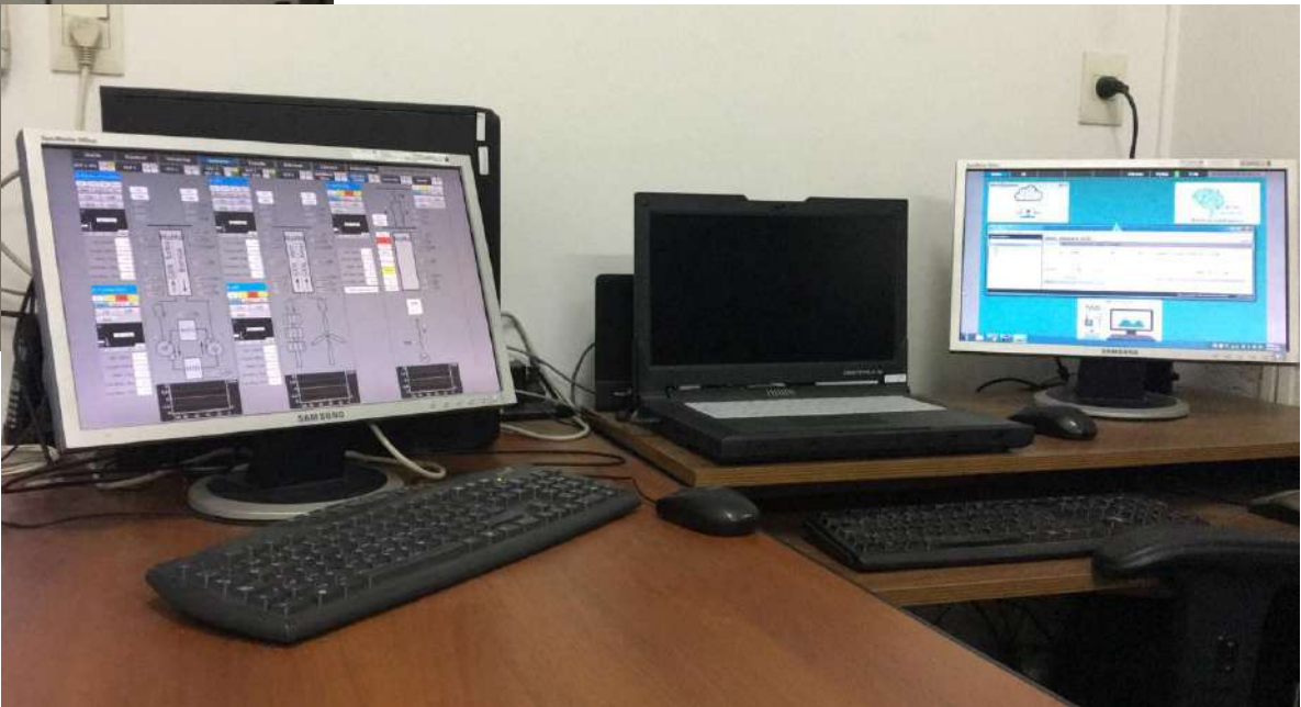
Imagen de la oficina de control, SCADA y servidor de comunicaciones TCSB.
