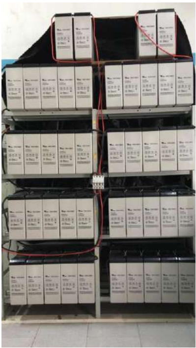
Banco de baterías de GEL o VRLA. (50%) 310Vcc @200A, 30kW/H
