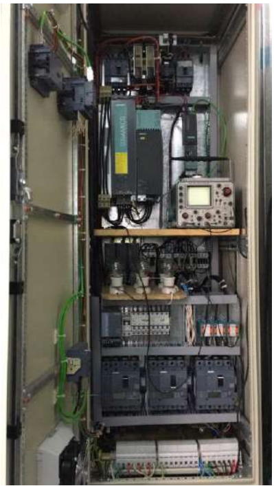
Gabinete de potencia. Inversor a la red, ON u OFF GRID.
